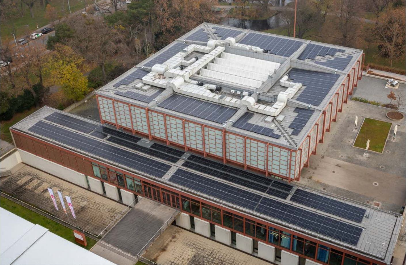
Klimafitte Kulturbetriebe, Solaranlage auf dem Dach des Belvedere 21
